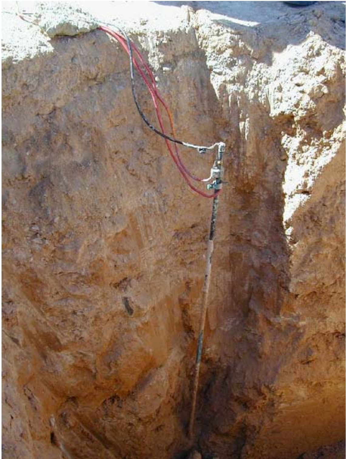
Рисунок 2. Покрытый медью на 5/8 дюйма стержневой заземляющий электрод длиной 2,45 м, извлеченный по прошествии 10 лет (Производственный участок Павни)
